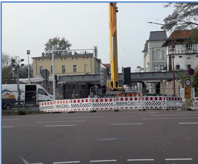
Brückenbau zur Erneuerung Eisenbahnstrecke Richtung Magdeburg Brücke über die Friedrich-Ebertstraße – bis März 2020
